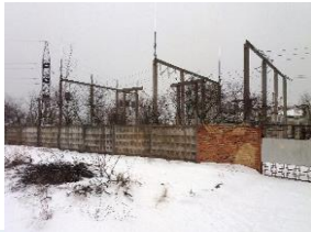
Electrical substation «Kyivoblenergo»
